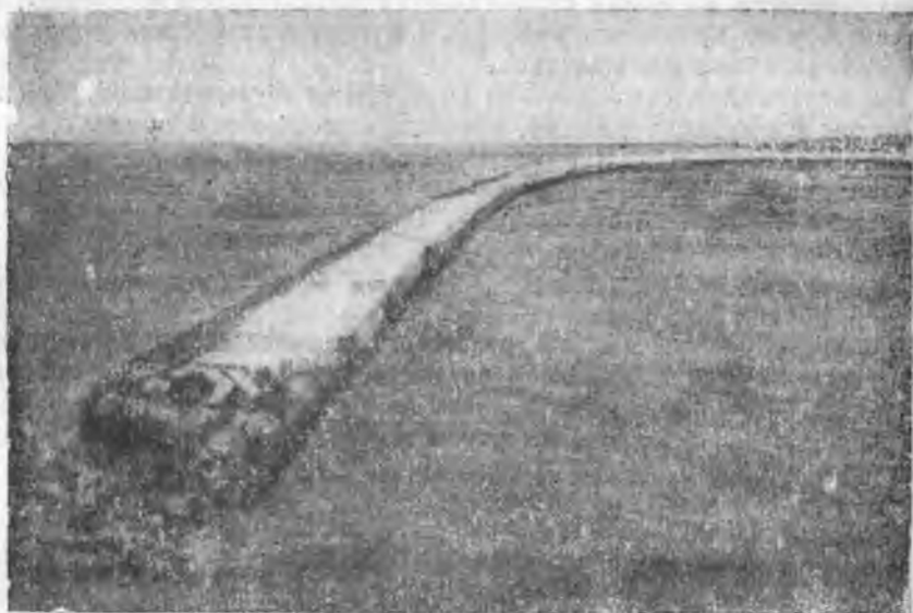
Рис. 134. Повреждения надводной стенки мола
