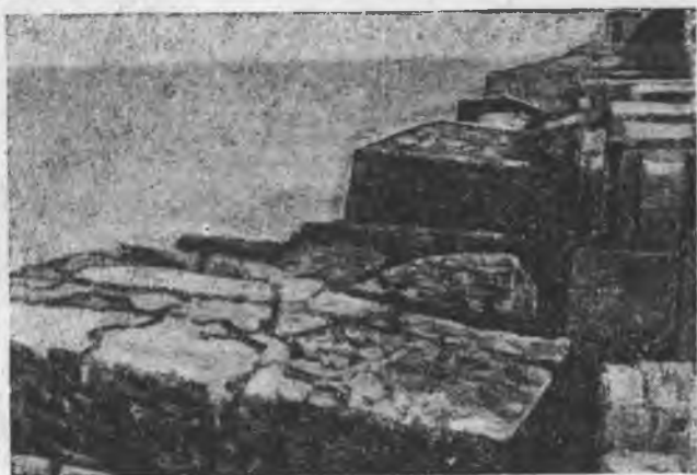
Рис. 195. Трещины в бутовом массиве
