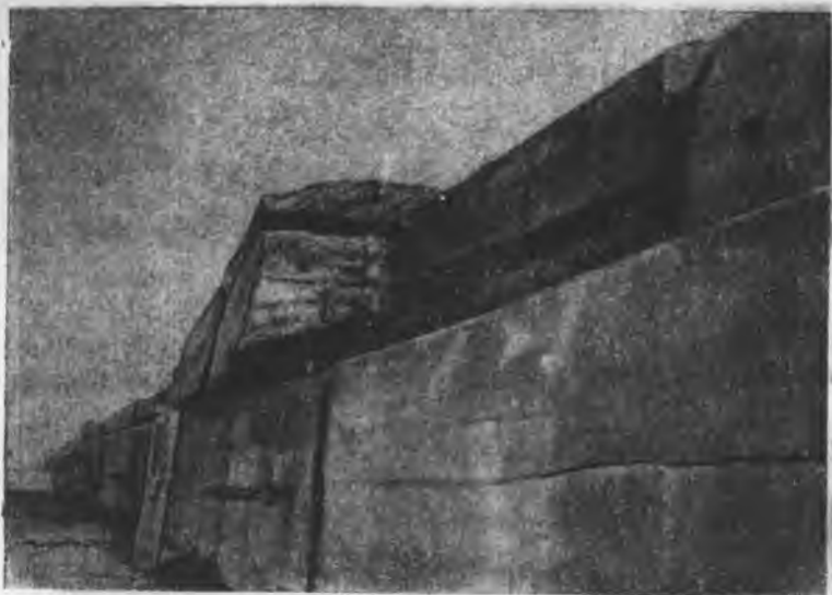
Рис. 42. Сдвиг парапета по надстройке на большой брешы
